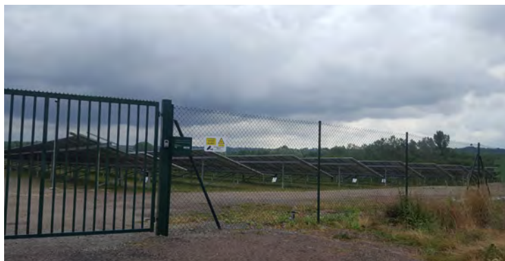
- Centrale solaire à Doyet -
