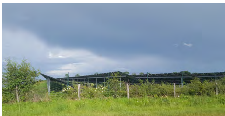
- Panneaux photovoltaïques à Verneix -
