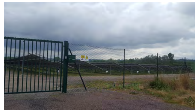
Centrale solaire au sol, Doyet [Source : Cittanova]
